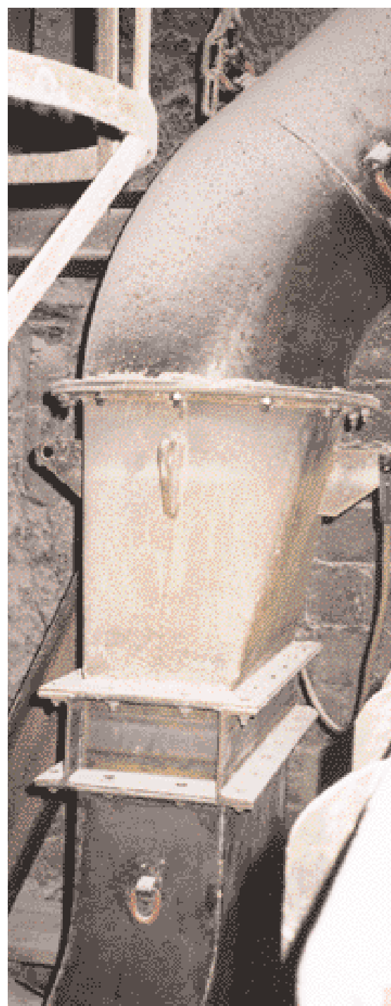
Entstaubungsverrohrung Skipbeladung Schacht Borth I
