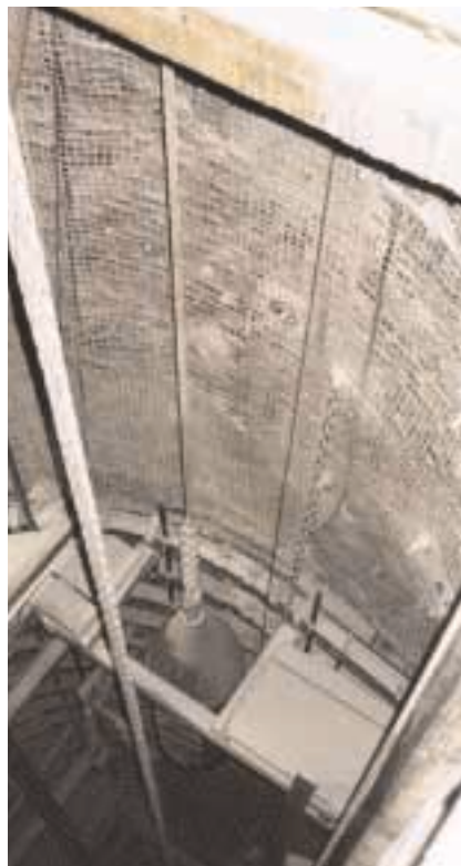
Fahrschacht und Absteigebühne unterhalb Skipbeladung Schacht Borth I
