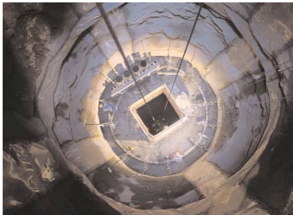
Gleiten des Schachtes
