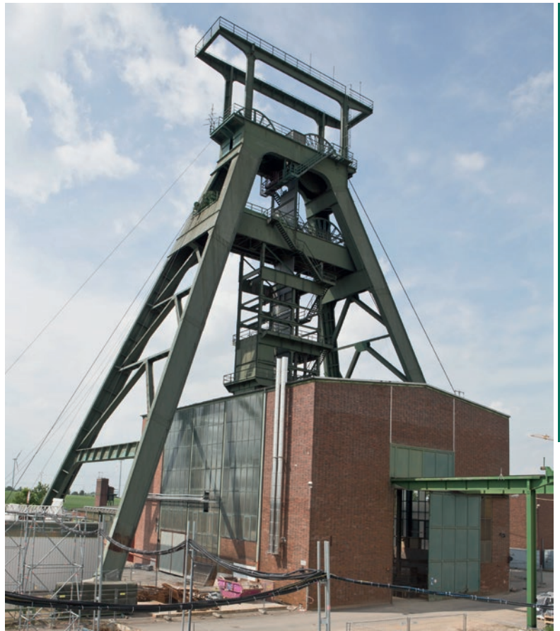
Подъемная машина, продукт компании OLKO Maschinenfabrik Возведение герметизационной перемычки в каменной соли Работы в стволе по строительству хранилища отходов «Конрад»
