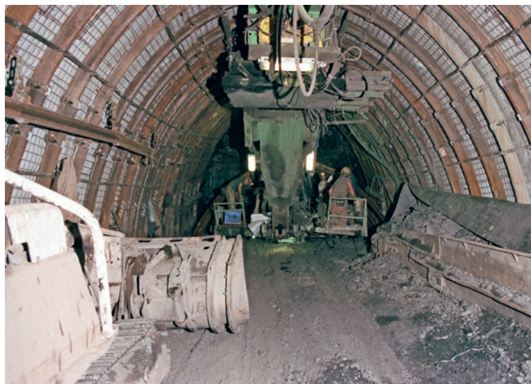
Проходческий подвесной полук GTA AMG 2800, самоходный погрузчик K 313 S и дробилка PF 3 / 600 дополняют комплекс проходческого оборудования
