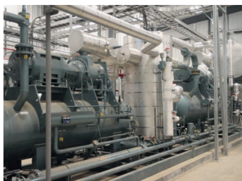
Изолированные рассольные трубопроводы, идущие к стволу
