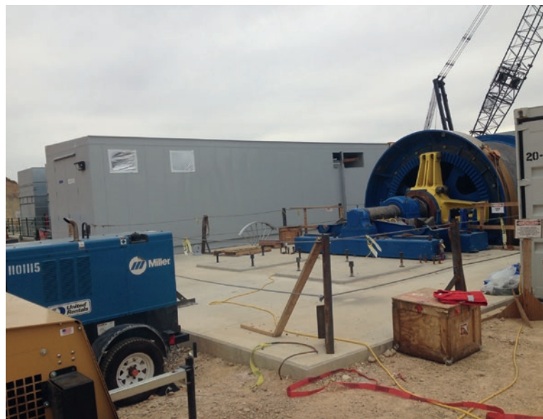
Контейнер с приводной частью проходческой подъемной машины (на фото сзади)
