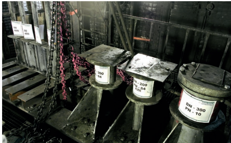
Опорная конструкция для инженерных коммуникаций
