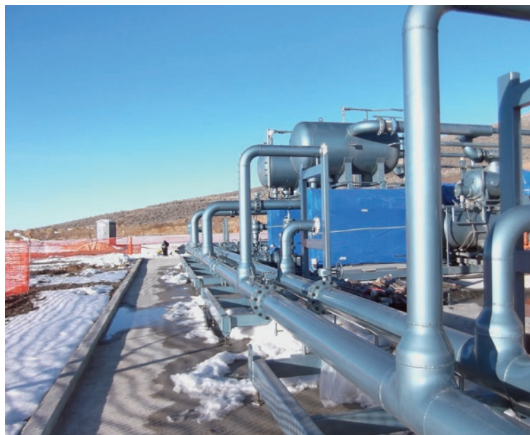
Подающие и обратные рассолные трубопроводы
