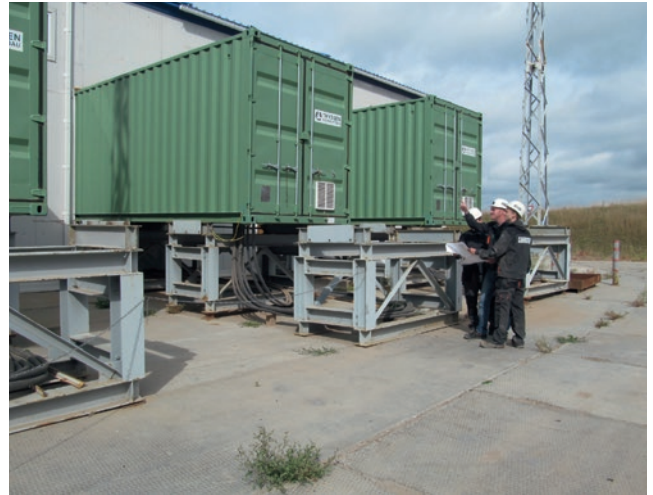
Вид на обогревательные установки во время ввода в эксплуатацию
