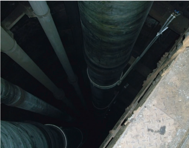
Трубы с креплениями в собранном состоянии
