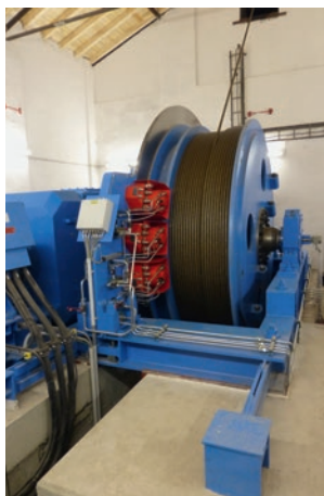
Подъемная машина в здании подъемных машин с опорной конструкцией и рамой привода
