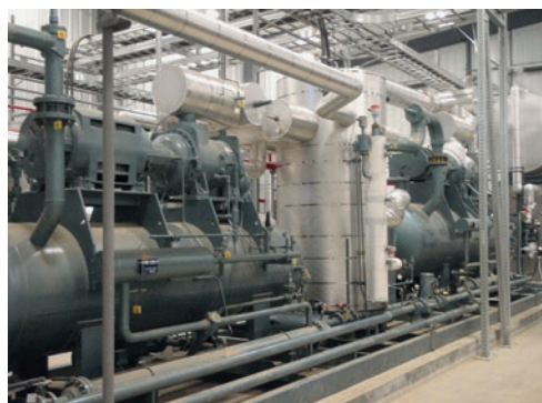
Abb. links: Geschützt verlegte Solerohr- leitungen zum Schacht
