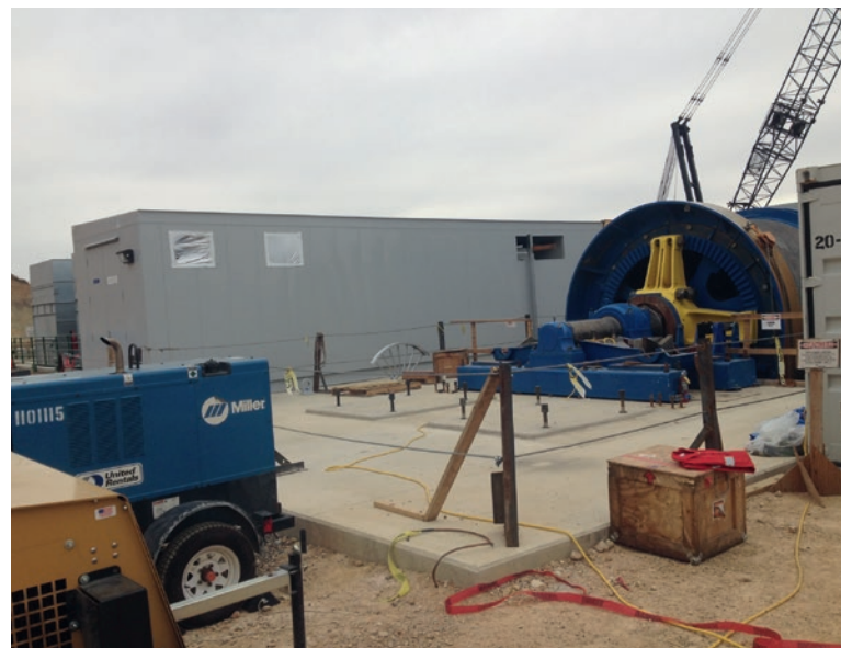
Teufhaspel-Antriebscontainer (im Bild hinten)
