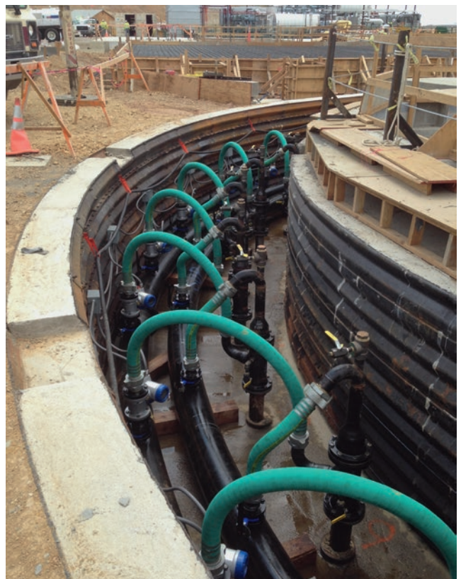
Im Gefrierkeller installierte Gefrierköpfe
