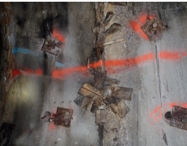
Risse und Abplatzungen der Segmente, hervorgerufen durch „Frostdruck“
