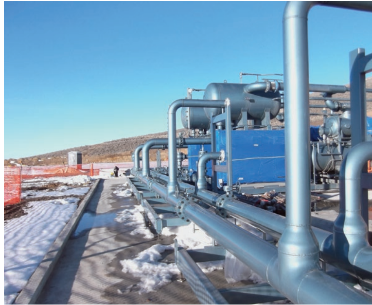
Sole-Vorlauf- und Rücklaufleitungen
