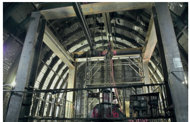
Einbaukonstruktion für Versorgungsleitungen
