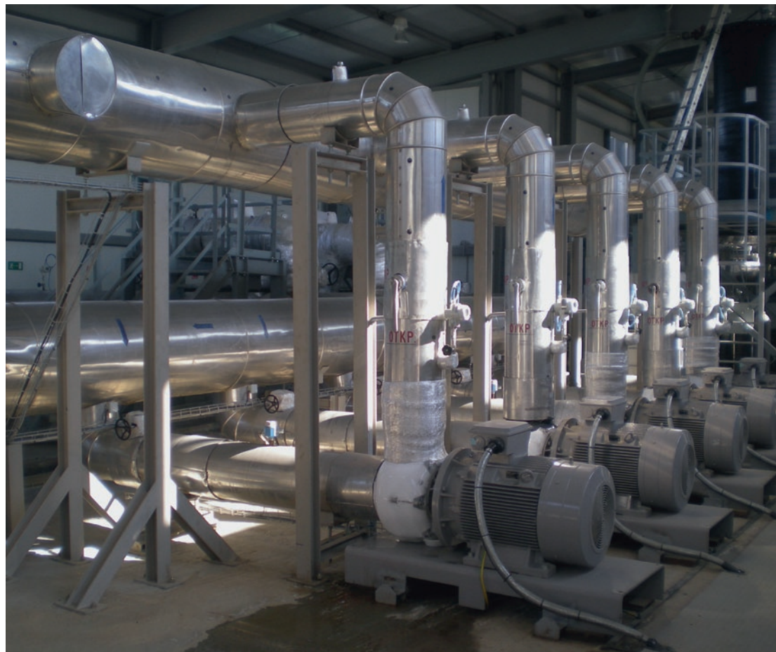
Kreiselpumpen zur Zirkulation des Kälte- bzw. Wärmeträgers
