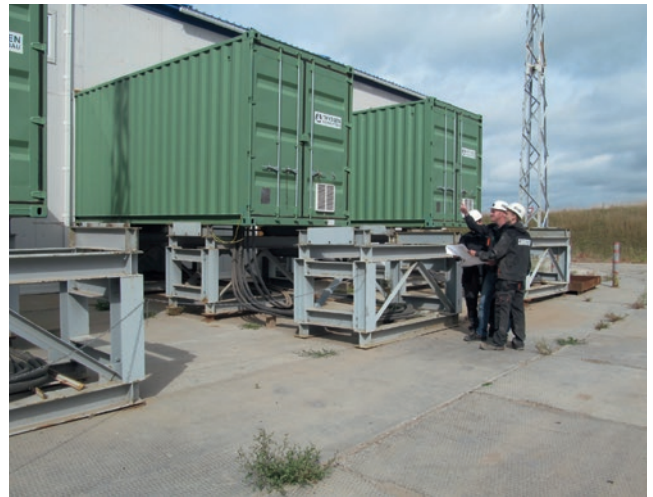
Blick auf die Heizmaschinen während der Inbetriebnahme
