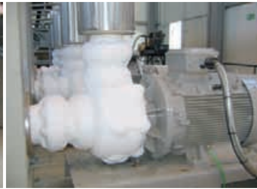
Eis auf den Solepumpen am Schacht 1
