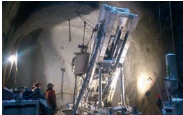
Raisebohranlage Wirth HG 160
