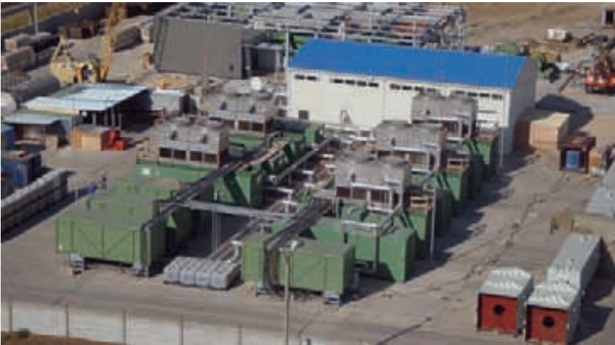
Gefrieranlage für den Skipschacht 1
