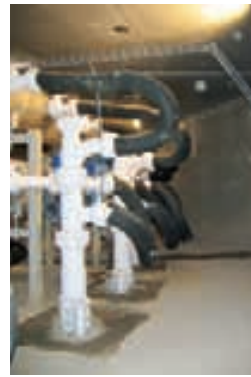
Soleköpfe im Gefrierkeller am Schacht 1
