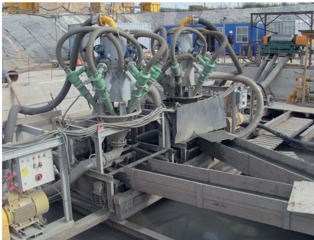
Anlage zur Abscheidung von Sand aus der Bohrspülung
