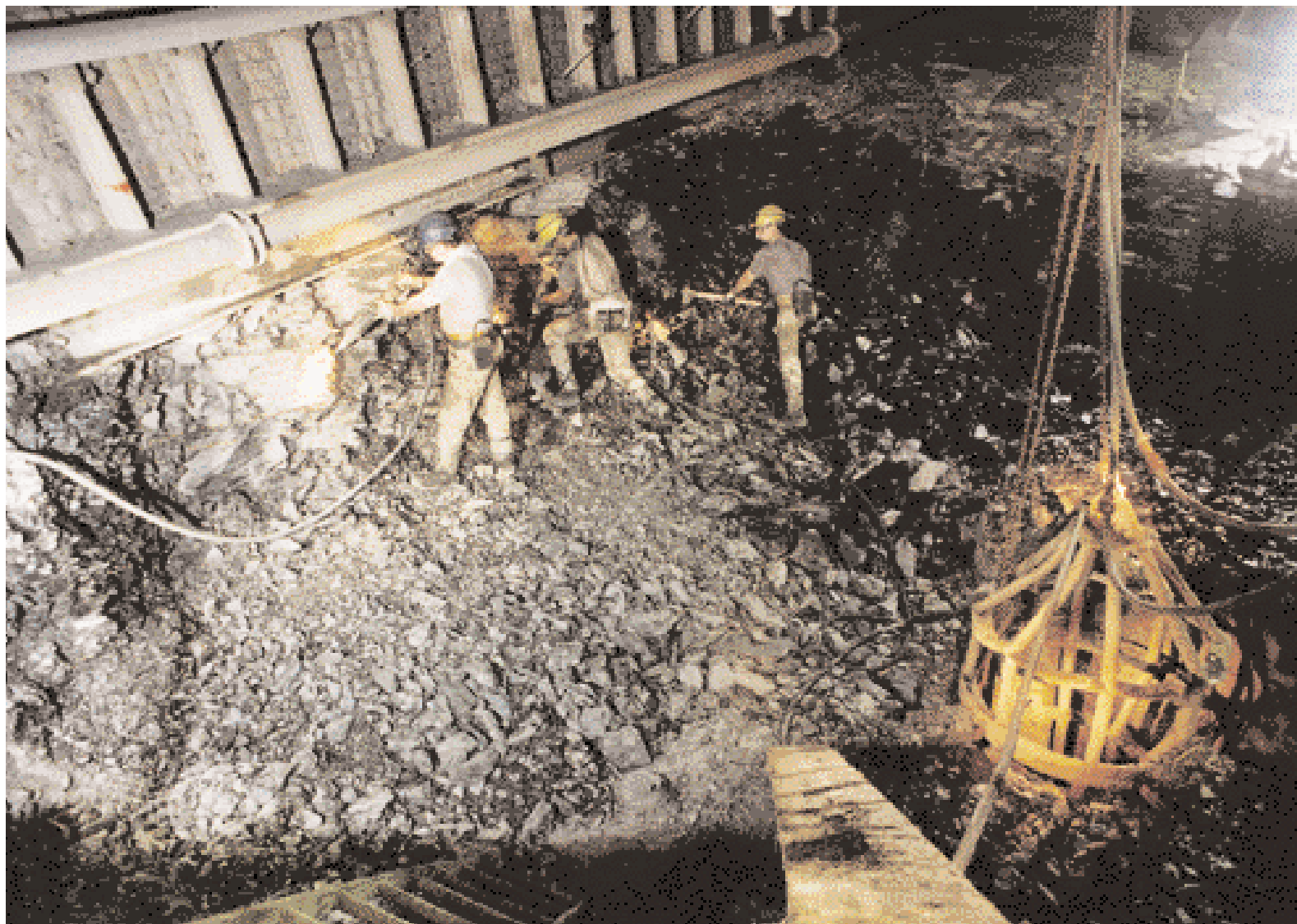
Der Ausbruch des Schachtkragens erstreckt sich weit unter den Streckenausbau der Überführung
