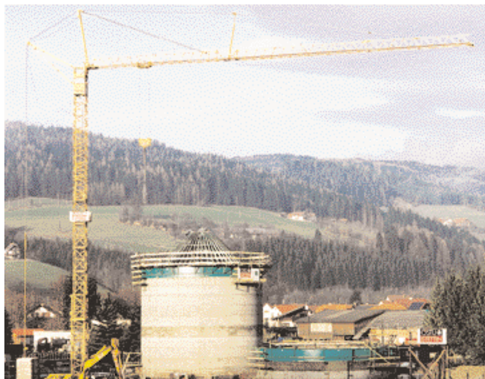
Faulbehälter mit kegelförmiger Dachschalung, Eindicker mit Kletterschalung
