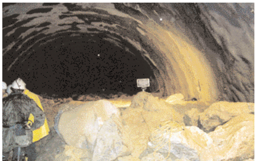
In den Tunnel eingeschwemmtes Material
