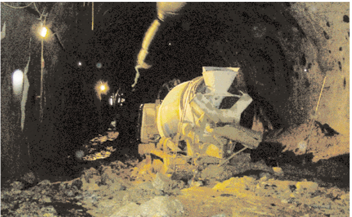
Betonfahrmischer in der Mure
