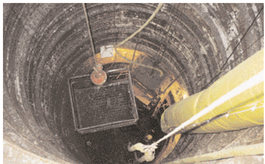
Schachtinneres mit Ausbau, Ausbauringen und Cryderman-Greifer
