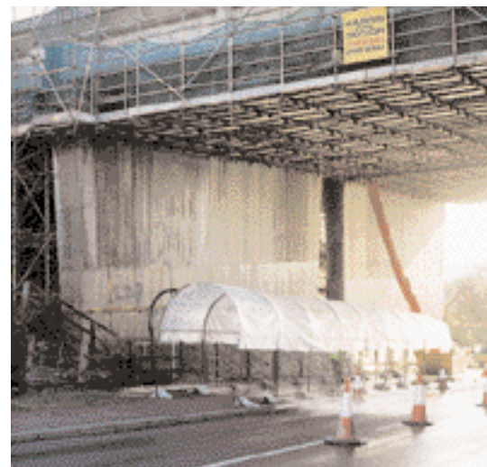
Einrüstung zur Ausführung der Brückenverstärkungsarbeiten der Whitehill Lane Brücke, Autobahn M1 und Gehweg mit vorläufigem Belag
