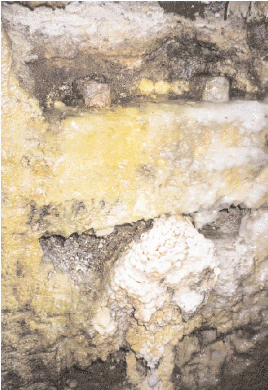
Inkrustierung an der Schachtwand
