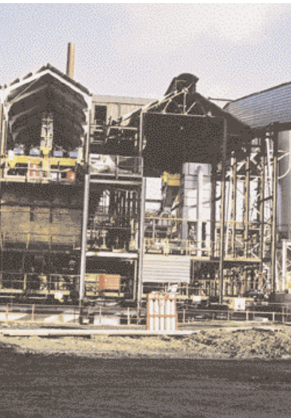
Teilansicht der Karbonisierungsanlage
