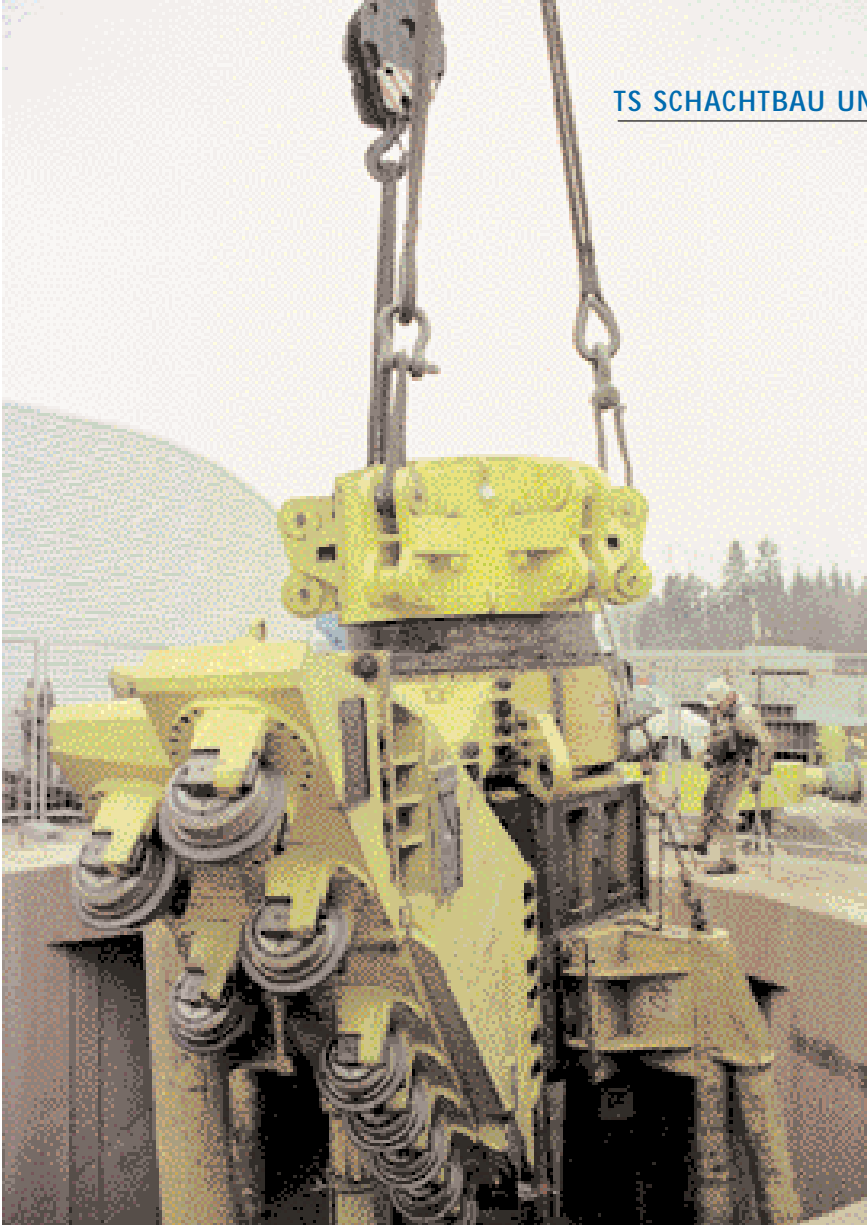
Montage der Schachtbohrmaschine Wirth SB VII, Einhängen des teilmontierten Bohrkopfes \varnothing 8,2 m
