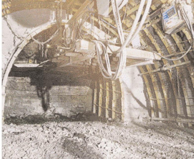
Querschnittsreduzierung aus dem südlichen Umtrieb zum Schacht 8
